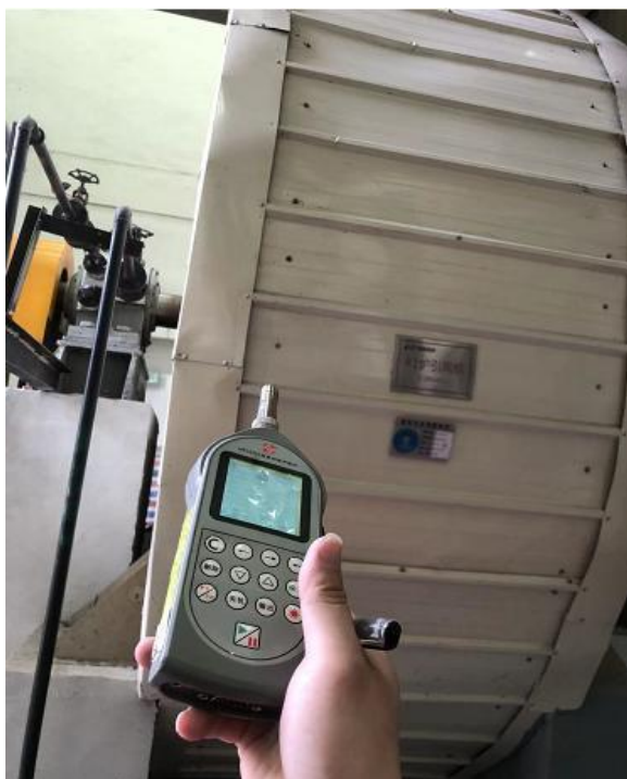
锅炉燃烧单元引风机
