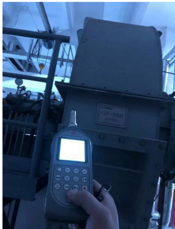
锅炉燃烧单元一次风机
